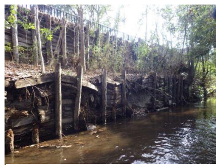
＜既設護岸（木柵）の破損＞
