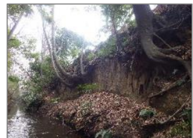
＜オーバーハング状法面に生育(a)＞
