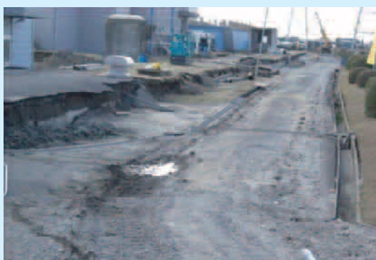
液状化による浄水場の被害
