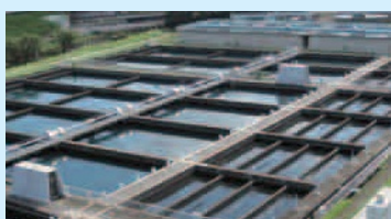
フロック形成池・薬品沈でん池
