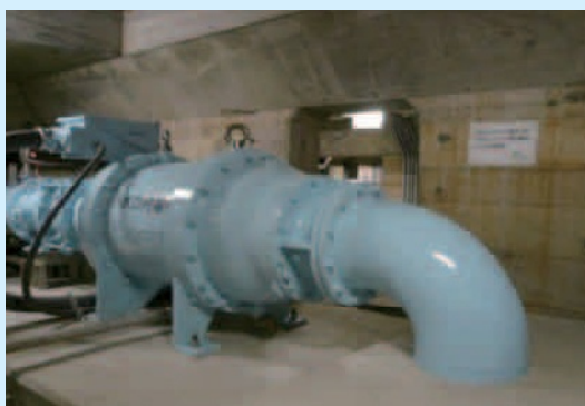
小水力発電設備
