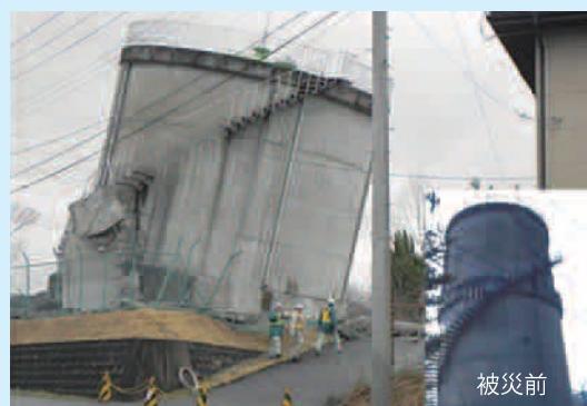
配水塔の倒壊
