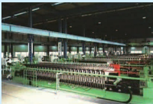
脱水機（朝霞浄水場）
