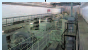
送配水ポンプ
