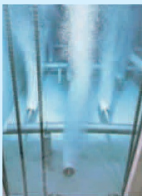
オゾン接触池
