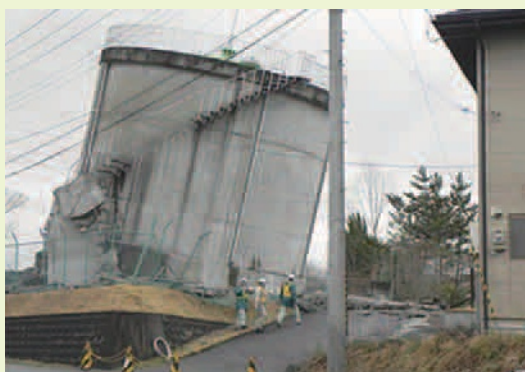
余震により倒壊した配水塔
