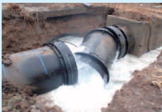
送水管の抜け出し
