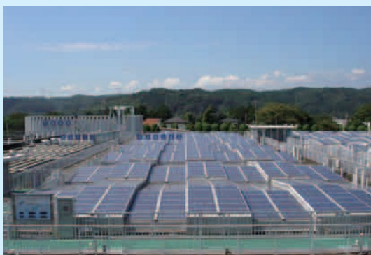
太陽光発電設備
