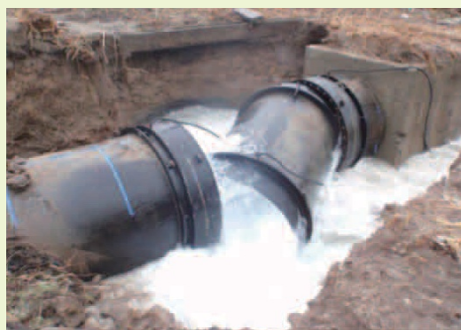
大口径送水管 (φ2400mm) の抜け出しによる被害
