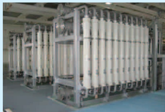
膜処理施設（砧浄水場）
