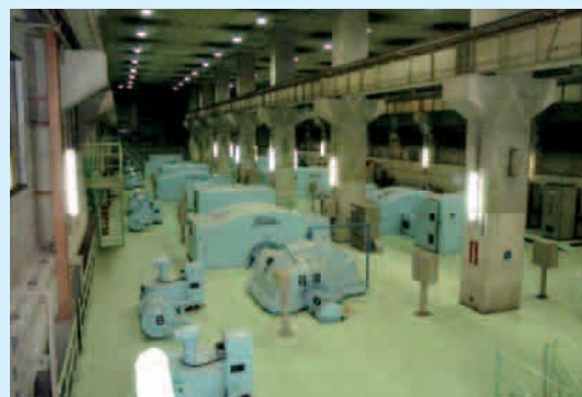
送配水ポンプ（朝霞浄水場）
