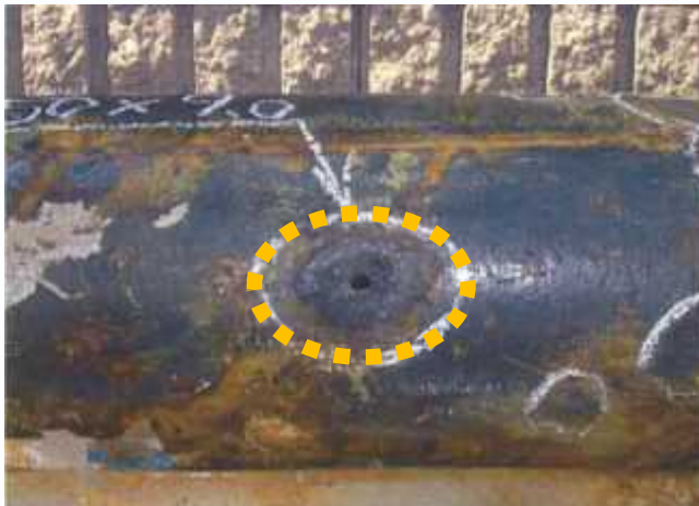
〈孔食の状況写真〉
