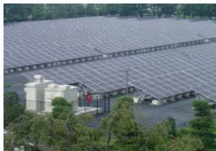
太陽光 発電設備 (東村山浄水場)
