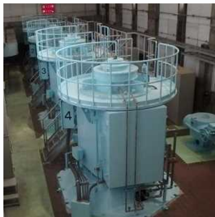
省エネ型ポンプ設備 (上井草給水所)
