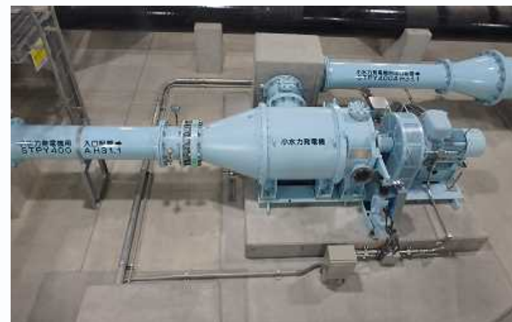
小水力発電設備 (江北給水所)
