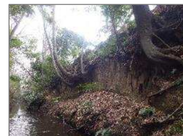
オーバーハング状法面に生育(a)
