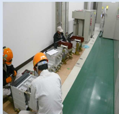
①遮断器点検
