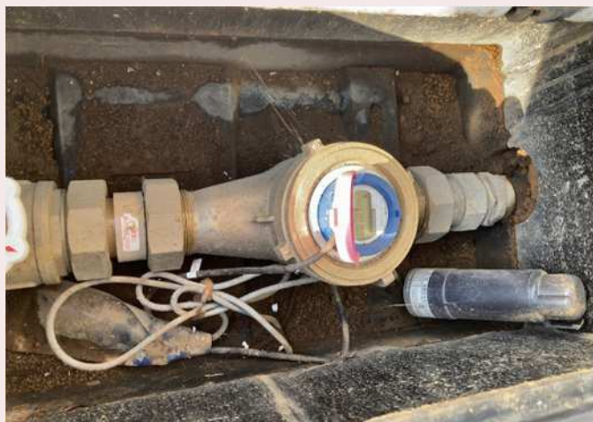
▲東京2020大会選手村（東京都中央区晴海）に設置しているスマートメータ
