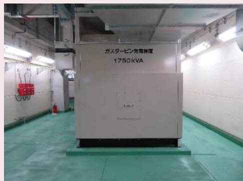
▲清瀬梅園給水所(非常用発電設備) 非常用発電設備を整備しました。
