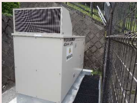
▲乙津第一配水所(非常用発電設備) 非常用発電設備を整備しました。
