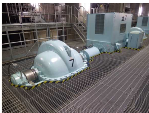
< 省エネ型ポンプ設備 >
