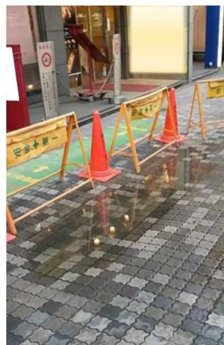
< 給水管漏水（舗装へ浸出） >
