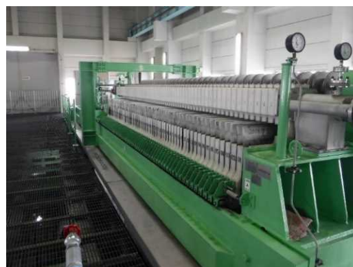
< 排水処理設備（脱水機） >
