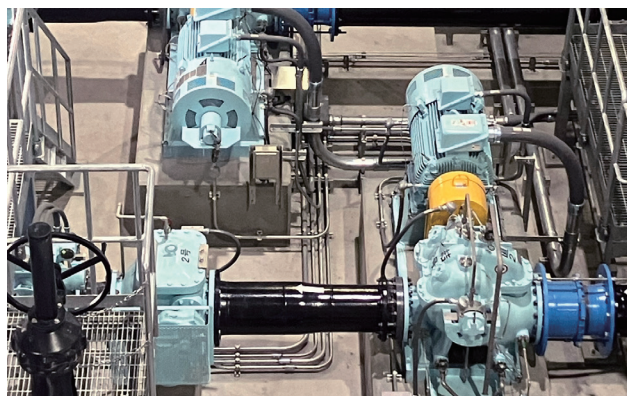
省エネ型ポンプ設備（上北沢給水所）
