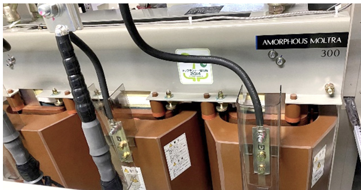
高効率変圧器（八雲給水所）
