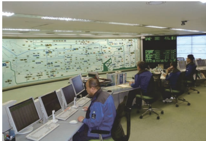
▲ 水運用センターの監視室
