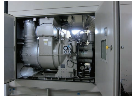
▲ 自家用発電設備
