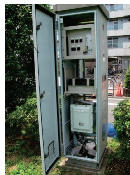
▲ 配水本管テレメータ
