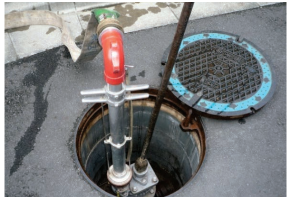
▲ 排水栓の消防活用
