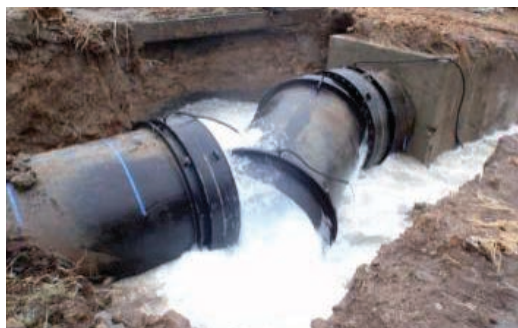
▲ 管路の抜け出し被害(送水管) (厚生労働省資料より)
