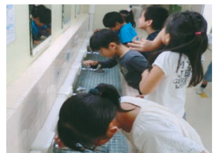
▲ 直結給水化モデル事業実施校
