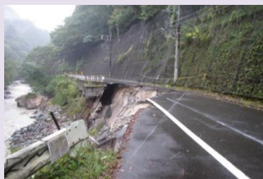
▲日原街道(平石橋付近)の崩落
