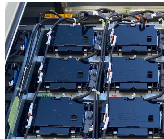
盤内リチウムイオン蓄電池
