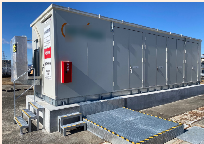
蓄電池コンテナ外観
