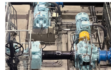
省エネ型ポンプ設備 (上北沢給水所)
