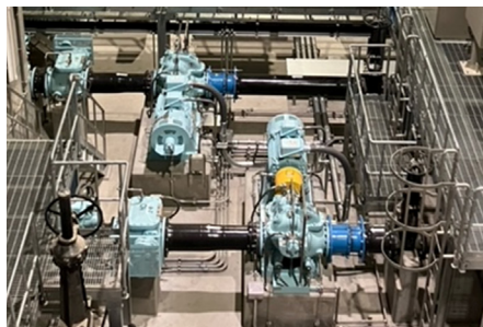
省エネ型ポンプ設備（上北沢給水所）
