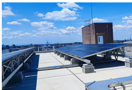
太陽光発電設備
