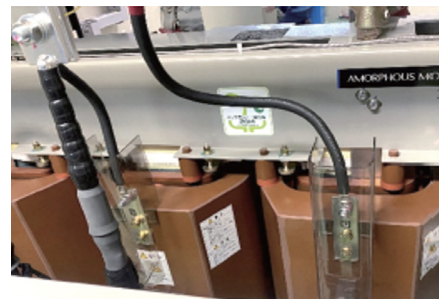
高効率変圧器（八雲給水所）
