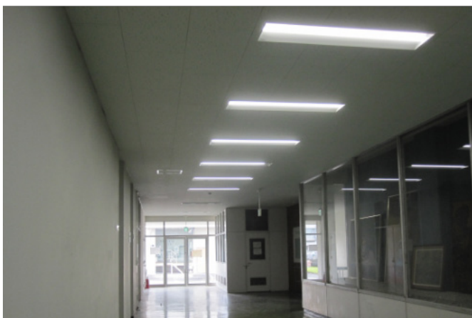
LED照明（東村山浄水場）
