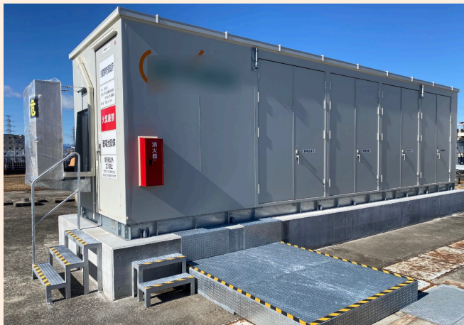
蓄電池コンテナ外観
