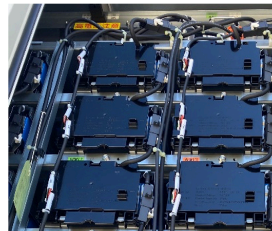
盤内リチウムイオン蓄電池
