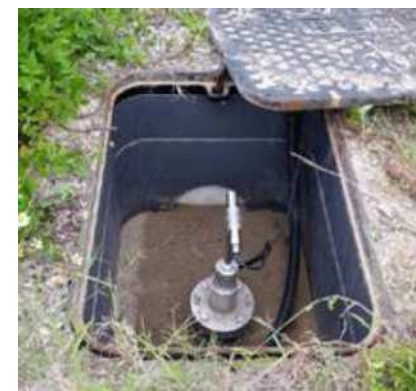
配水管への流量計設置状況
