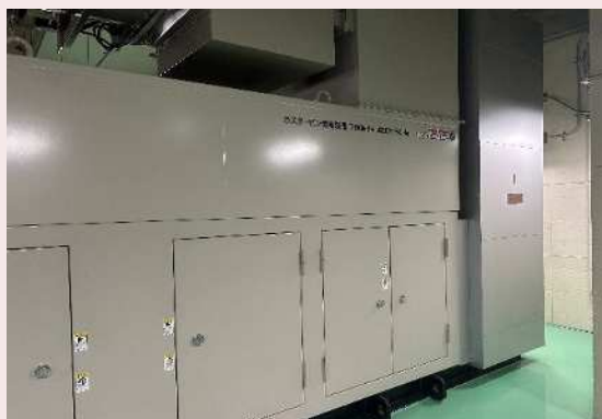
▲石畑増圧ポンプ所(非常用発電設備) 非常用発電設備を整備しました。
