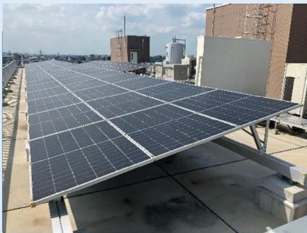
▲太陽光発電設備(上北沢給水所) 上北沢給水所に太陽光発電設備を整備しました。
