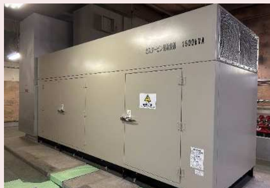
▲北野増圧ポンプ所(非常用発電設備) 非常用発電設備を整備しました。
