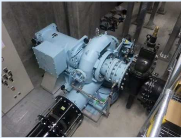
▲小水力発電設備(東海給水所) 東海給水所に小水力発電設備を設置しました。
