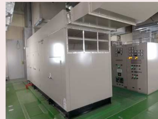
▲上北沢給水所(非常用発電設備) 非常用発電設備を整備しました。
