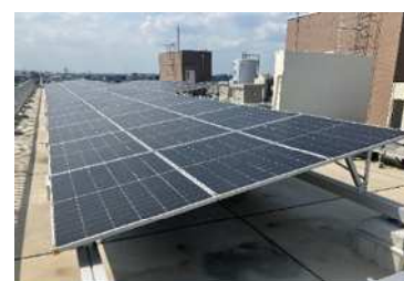
▲太陽光発電設備の整備 (上北沢給水所)
