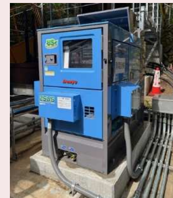
▲余ヶ野ポンプ所(非常用発電設備) 非常用発電設備を整備しました。
