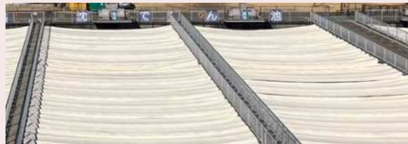
▲シート型による沈殿池の覆蓋化(長沢浄水場) 令和6年度に覆蓋化の工事が完了しました。
