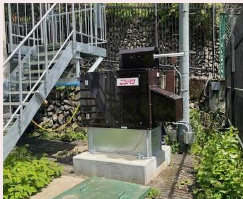
▲棚澤第一ポンプ所(非常用発電設備) 非常用発電設備を整備しました。
