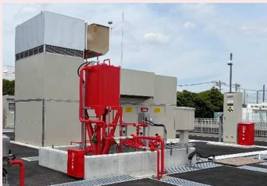
▲砧下浄水所(非常用発電設備) 非常用発電設備を整備しました。
