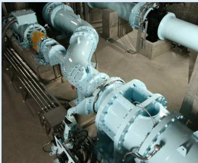
▲小水力発電設備(上北沢給水所) 令和6年度に設置完了し、令和7年度から発電を開始しました。
