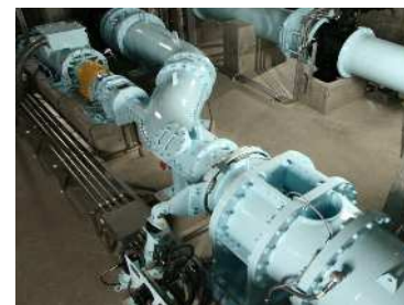
▲小水力発電設備の整備 (上北沢給水所)
