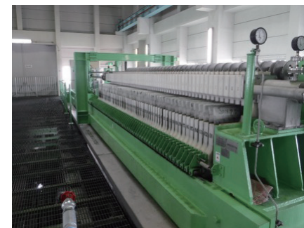
<排水処理設備（脱水機）>
