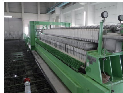
<排水処理設備（脱水機）>
