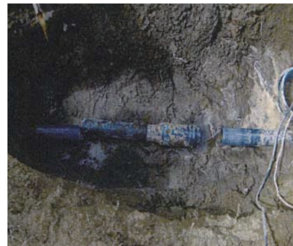
<漏水が発生した塩化ビニル製の給水管>
