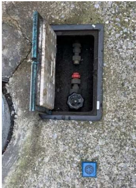
図 15 長期間水道メータが 取り外されている給水管
