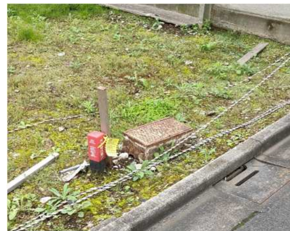
図 16 使用見込みがないまま 放置されている給水管
