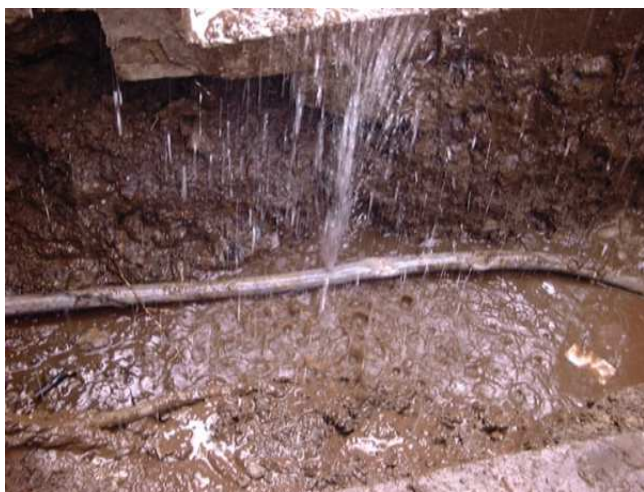
図 11 鉛製給水管の漏水状況
