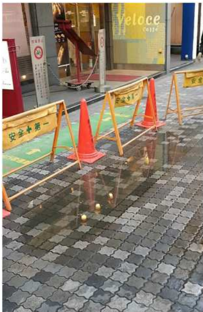
図 14 給水管漏水 (舗装へ浸出)
