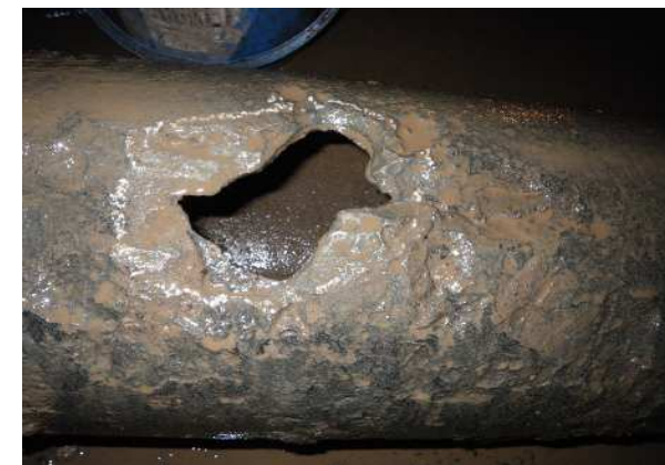
図 2 铸铁管の腐食漏水
