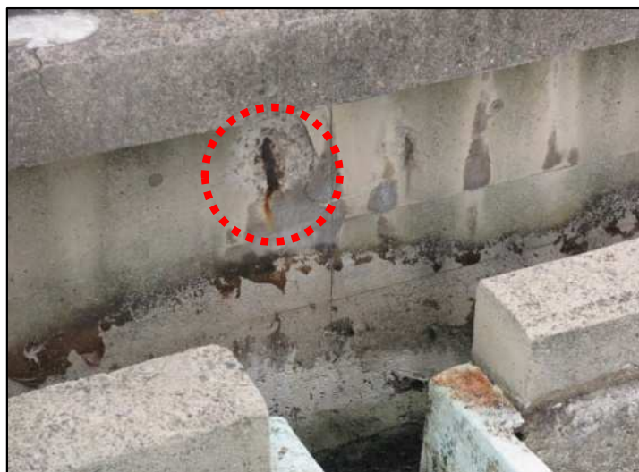
浮き・剥離事例
