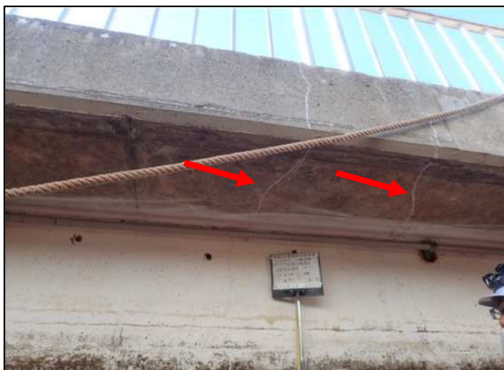
ひび割れ事例
