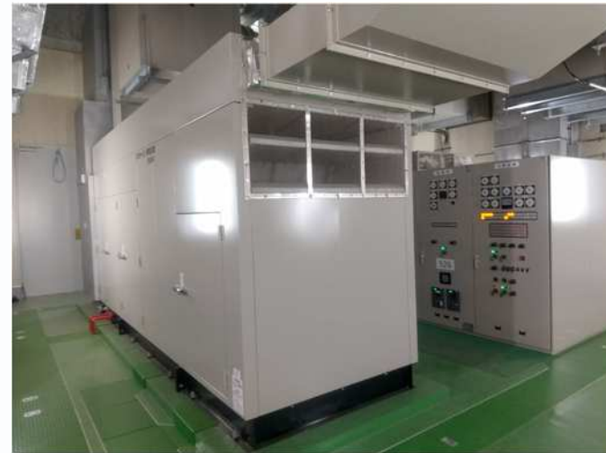
< 非常用発電設備（上北沢給水所） >
