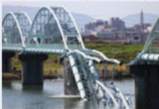
▲六十谷水管橋落橋
