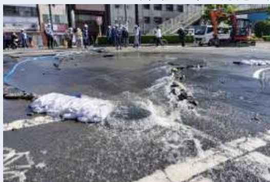
▲京都市における漏水事故
