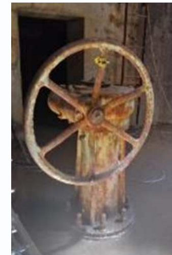
仕切弁開閉台
