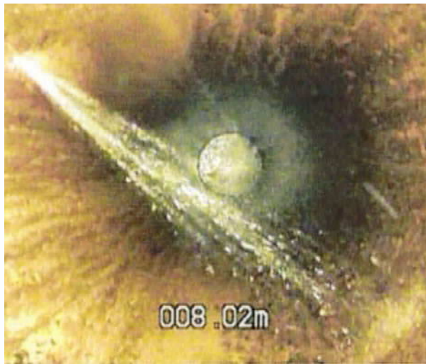
▲老朽化による井戸の破損状況
