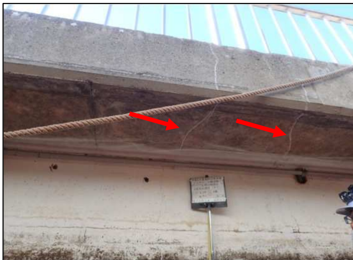
ひび割れ事例
