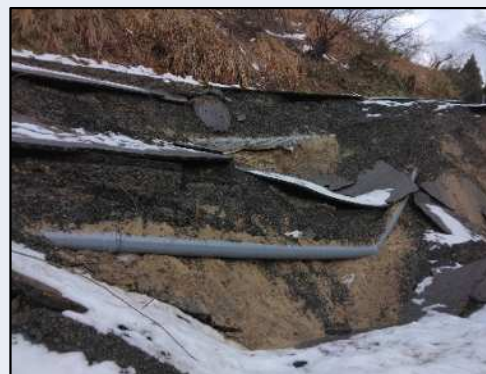
▲送水管の破損・露出（輪島市）
