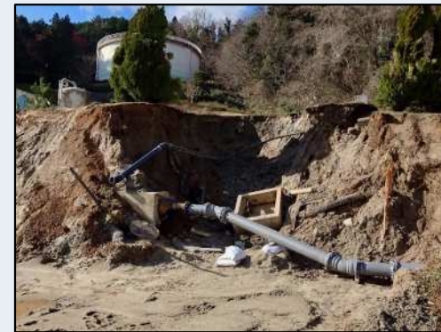
▲浄水場内の配管損傷（七尾市）
