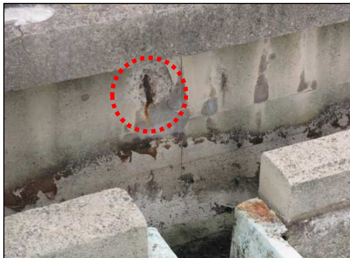
浮き・剥離事例
