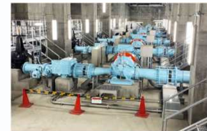
▲ 省エネ型ポンプ設備
