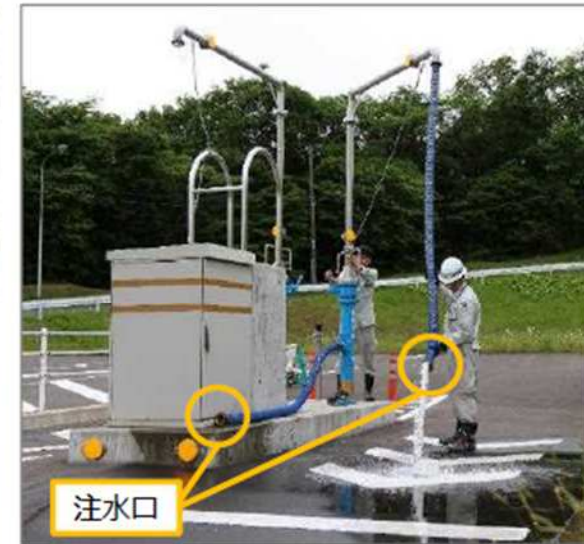
〔仙台市の給水車用給水栓〕
