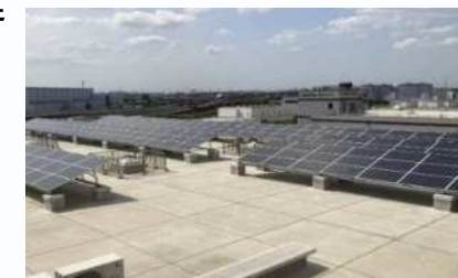
▲ 太陽光発電設備
