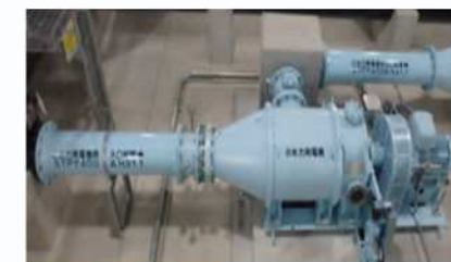
▲ 小水力発電設備
