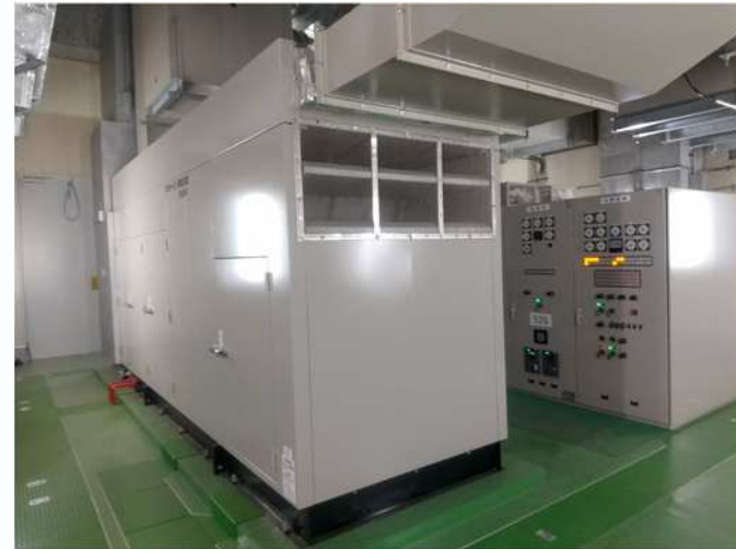
< 非常用発電設備（上北沢給水所） >
