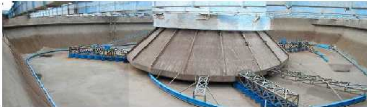
高速凝集沈殿池内部
