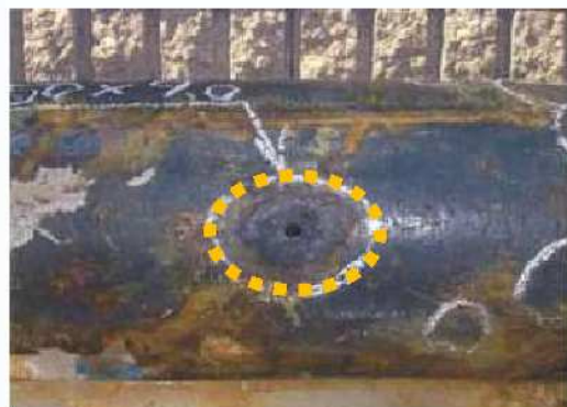
〈孔食の状況写真〉
