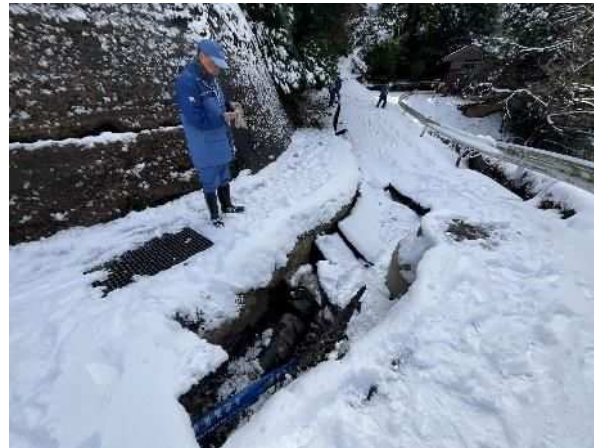
輪島市 送水管損傷
