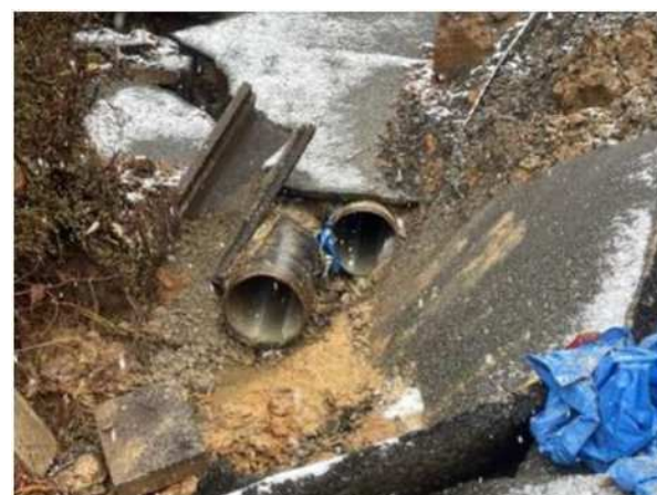
輪島市 送水管損傷
