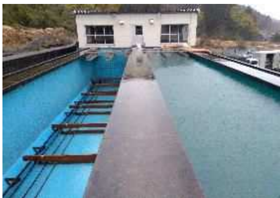
浄水場の被害(珠洲市)
