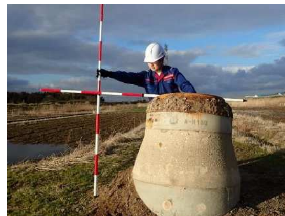
マンホール浮上現場(中能登町)
