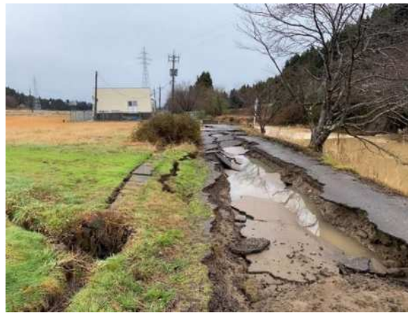
【被害状況】珠洲市宝立浄水場（導水管）
