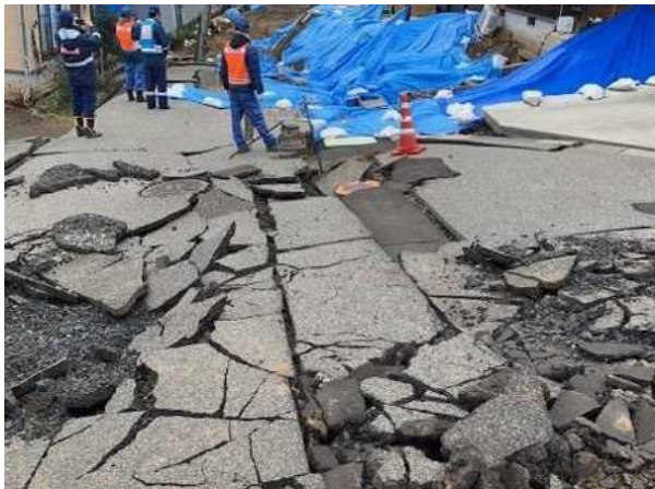
能登町 水道管損傷
