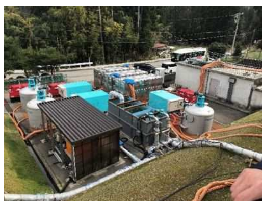
可搬式浄水装置の設置による補水地点の増設 (珠洲市 宝立浄水場)
