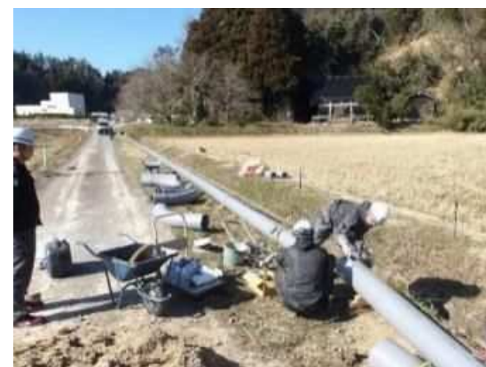
下水を集約し処理場へ送る圧送管の被災現場(珠洲市)
