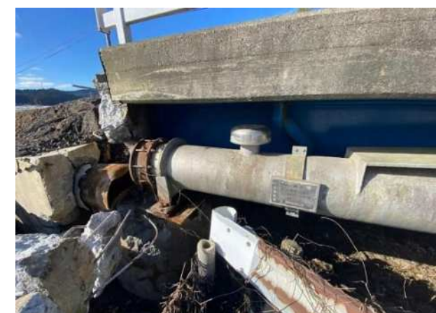
珠洲市 水管橋損傷
