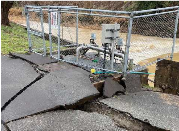
【被害状況】珠洲市宝立浄水場（取水口）
