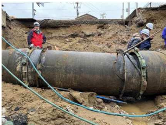
送水管の被害(七尾市)
