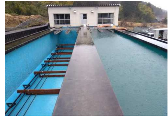
【被害状況】珠洲市宝立浄水場（沈殿池）
