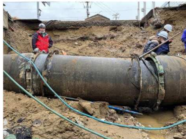
七尾市 送水管損傷
