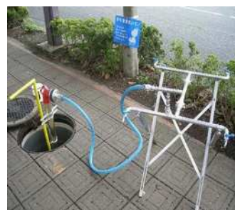
消火栓からの仮設給水栓
