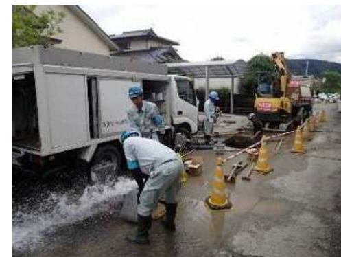
H28 熊本地震 (応急復旧)
