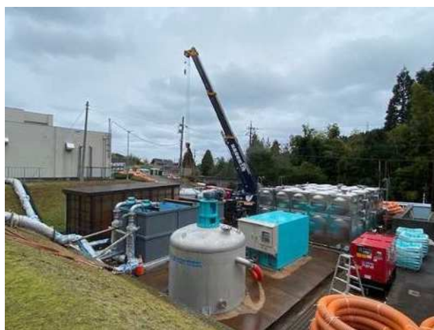
宝立浄水場可搬式浄水施設・設備
