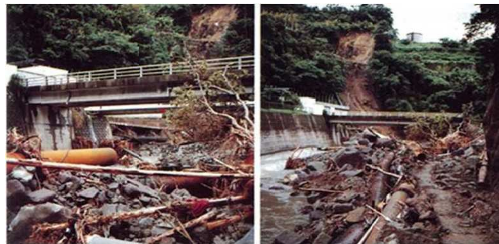
破損した滝之神浄水場の導水管
