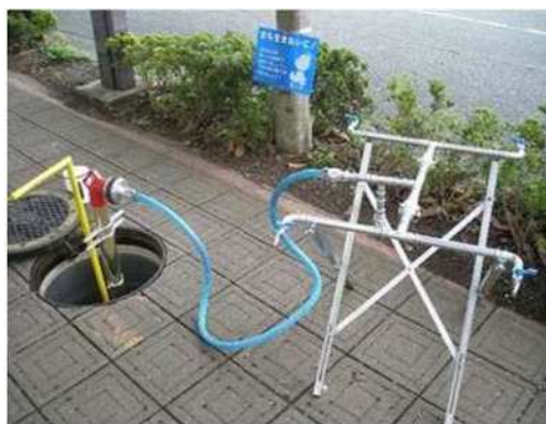
消火栓からの仮設給水栓
