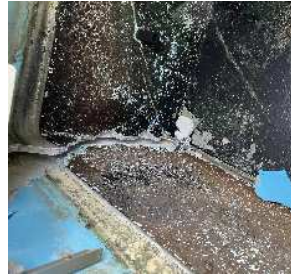
浄水場沈殿池の躯体ひび割れ
