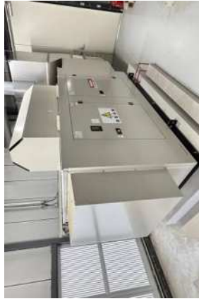
非常用発電機（矢原浄水場）
