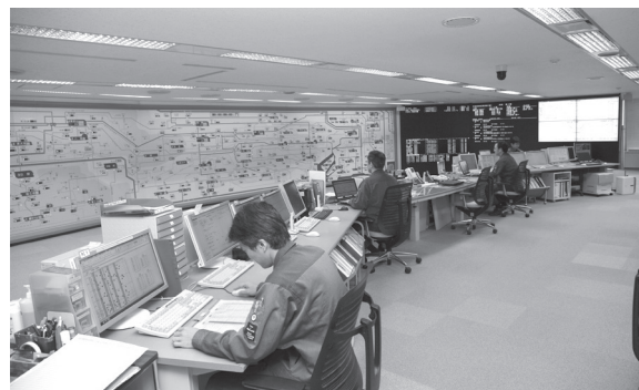
水運用センター監視室
