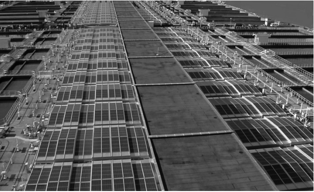
太陽光発電（朝霞浄水場）
