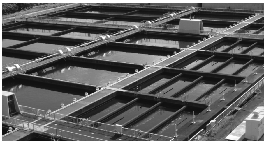
フロック形成池、沈殿池
