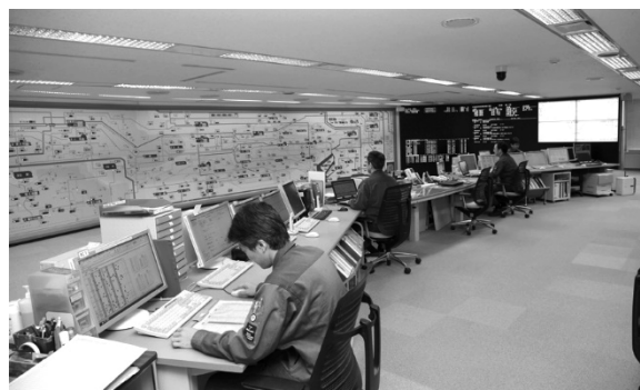
水運用センター監視室
