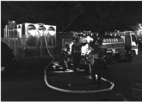
福祉施設の受水槽へ給水（静岡市）
