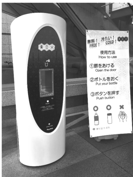
東京国際フォーラムに設置している水飲栓（D S）
