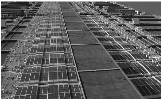
太陽光発電（朝霞浄水場）
