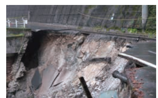
▲ 道路がぐずれてこわれてしまった水道管
