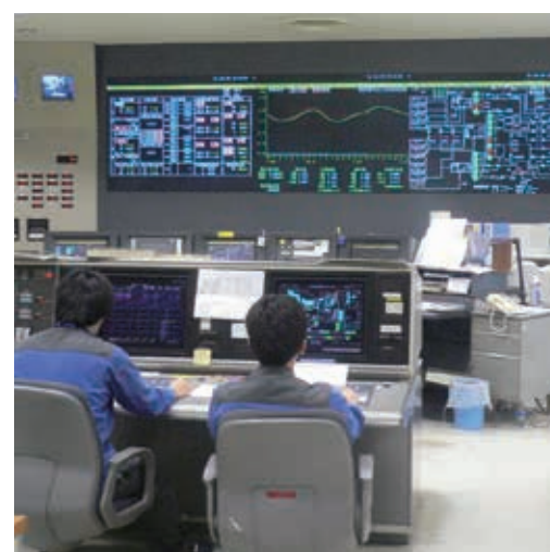
▲ 浄水場全体をコントロールしている管理室
