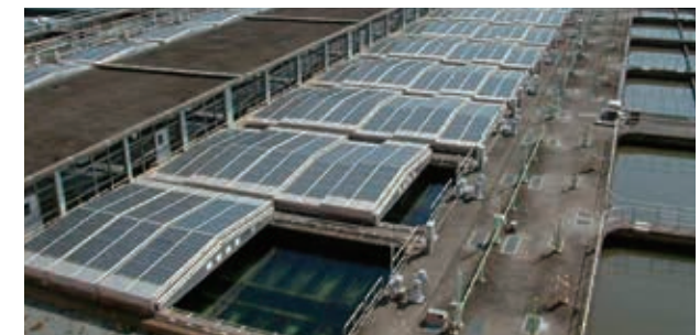
ろ過池の上の太陽電池
