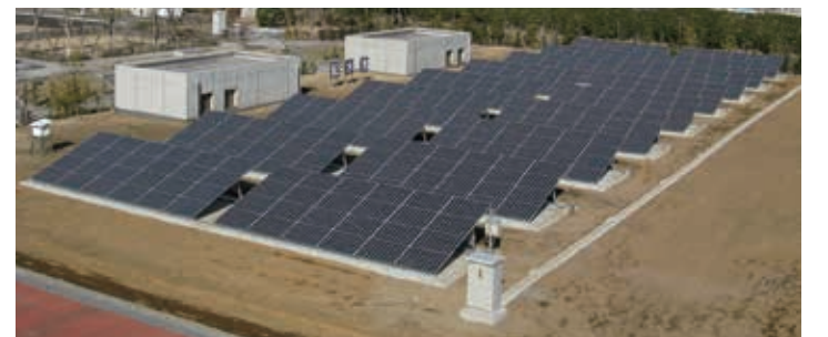
配水池の上の太陽電池
