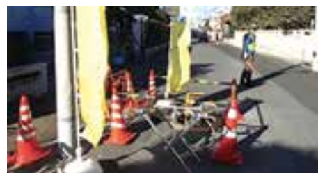
消火栓からの応急給水
