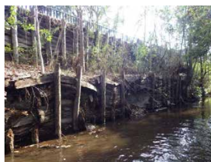
＜既設護岸（木柵）の破損＞
