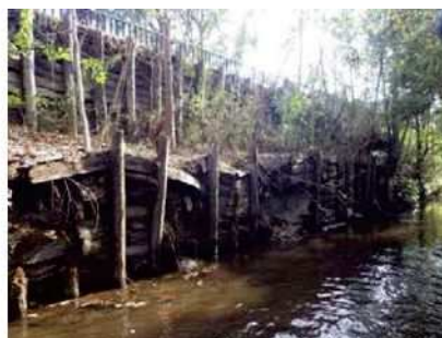
＜既設護岸（木柵）の破損＞
