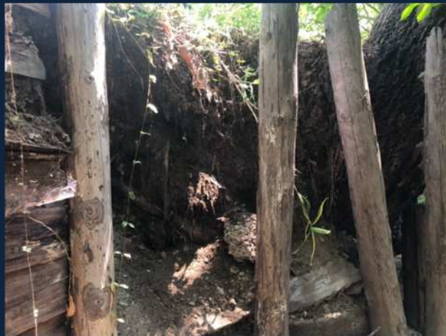
既存木柵 崩落状況 (R7.7撮影)
