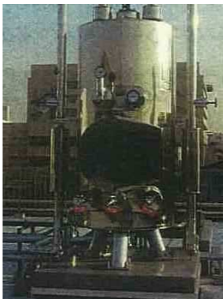
直結型非常用貯水槽（管）
