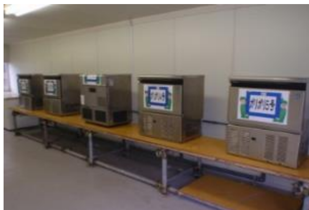
○熱中症対策のため製氷機を設置
