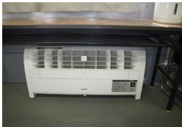
○空気清浄機を設置
