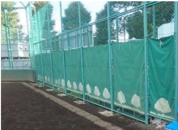
○隣接野球場に配慮した緑色の防音シート
