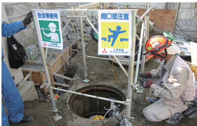
防止坠入人窞井内的措施
