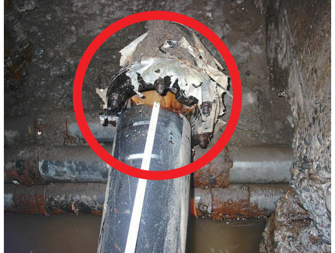
未设置防护装置导致管道脱落
