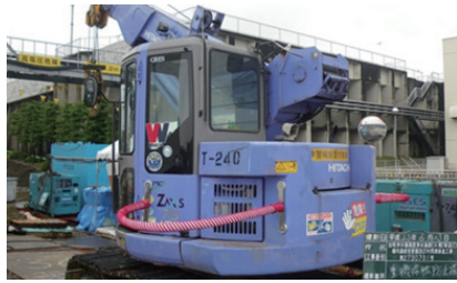
挖掘机防碰撞装置
