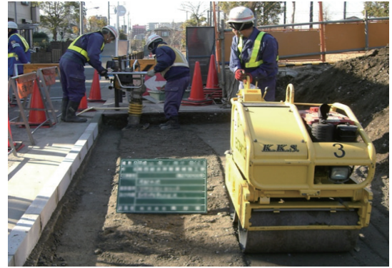
Công tác đầm nén có bằng xe lu và công nhân (Thi công trong tình trạng đồng đức là cực kỳ nguy hiểm)
