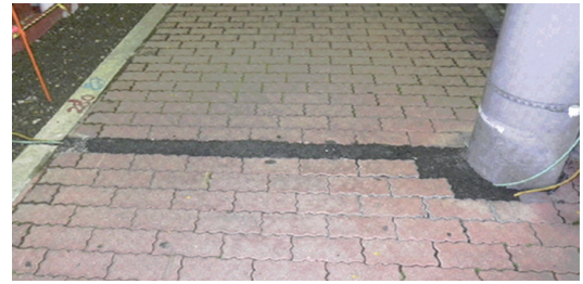
Dây cáp được chôn dưới lòng đất
