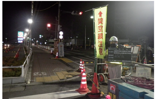
Maglagay ng sign na "overhead lines caution" sa lupa
