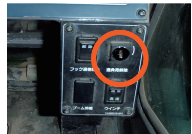
Butas para sa "susi" ng overload prevention device.
