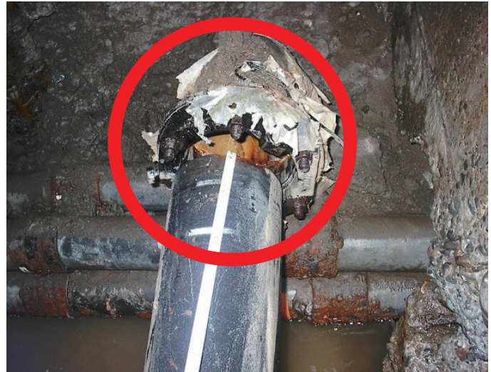
Pipa terlepas karena tidak dipasang pelindung
