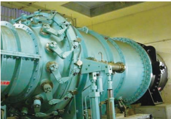
▲ 水力発電設備（東村山浄水場）
