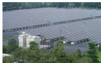
【太陽光発電設備】
