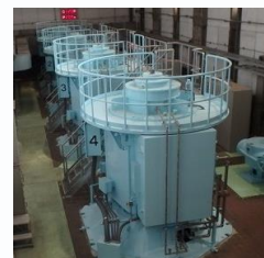
【省エネ型ポンプ設備】
